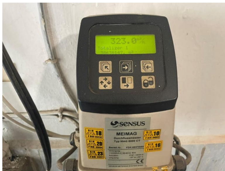
Slika 57. Automatski mjerач protoka u hlornoj stanici (11.03.2024)
