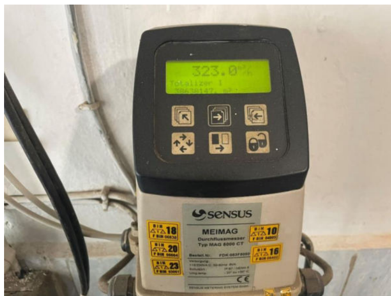
Slika 57. Automatski mjerач protoka u hlornoj stanici (11.03.2024)
